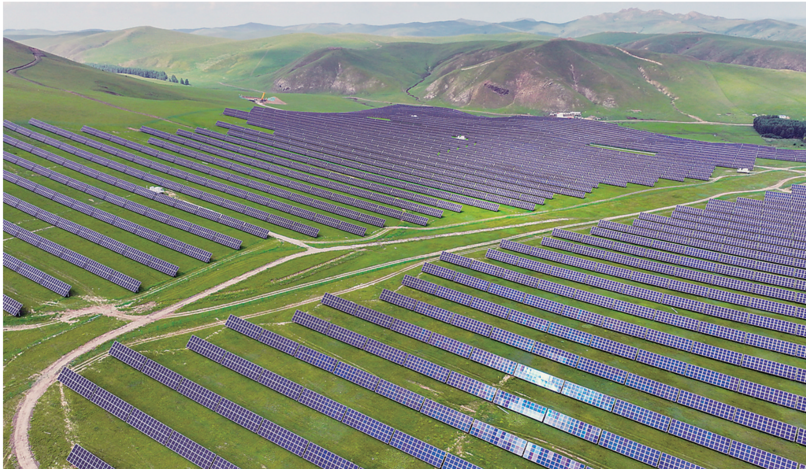
这是8月17日拍摄的内蒙古通辽市霍林郭勒100MW复合光伏项目(无人机照片)。
