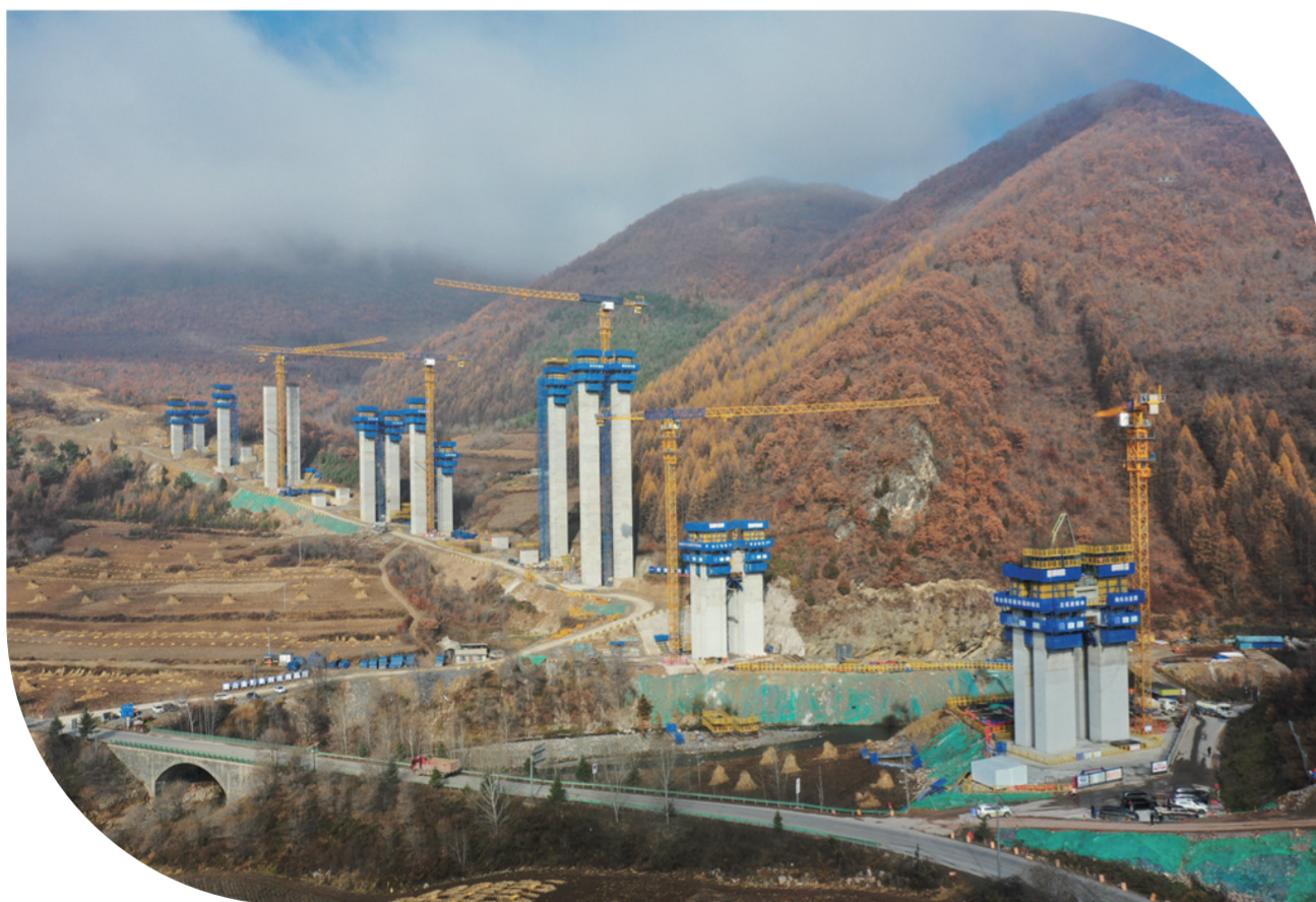
松江河至长白山高速公路项目06工区元宝山特大桥施工现场。
