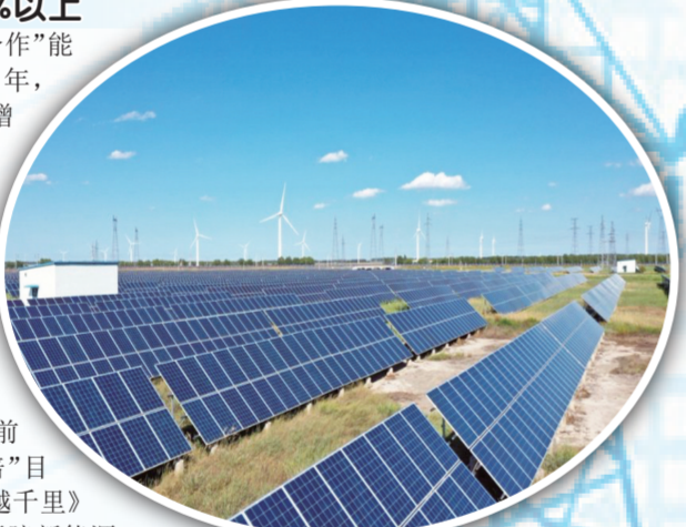
吉林四平双辽猛犸辽河光伏电站,装机规模15兆瓦。郭庆 摄
