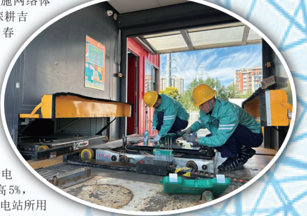
中秋节前,国网吉林电力工作人员开展节前换电设备设施检修,确保车辆安全满电出行。陶爽 摄
