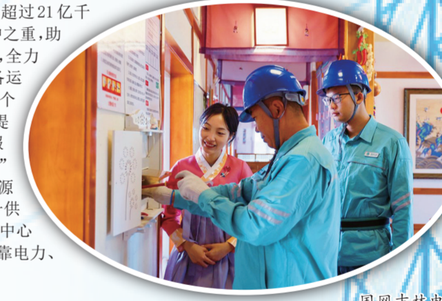
国网吉林电力工作人员深入延吉市春兴民宿,检查电采暖用电设施。冷鹏 摄
