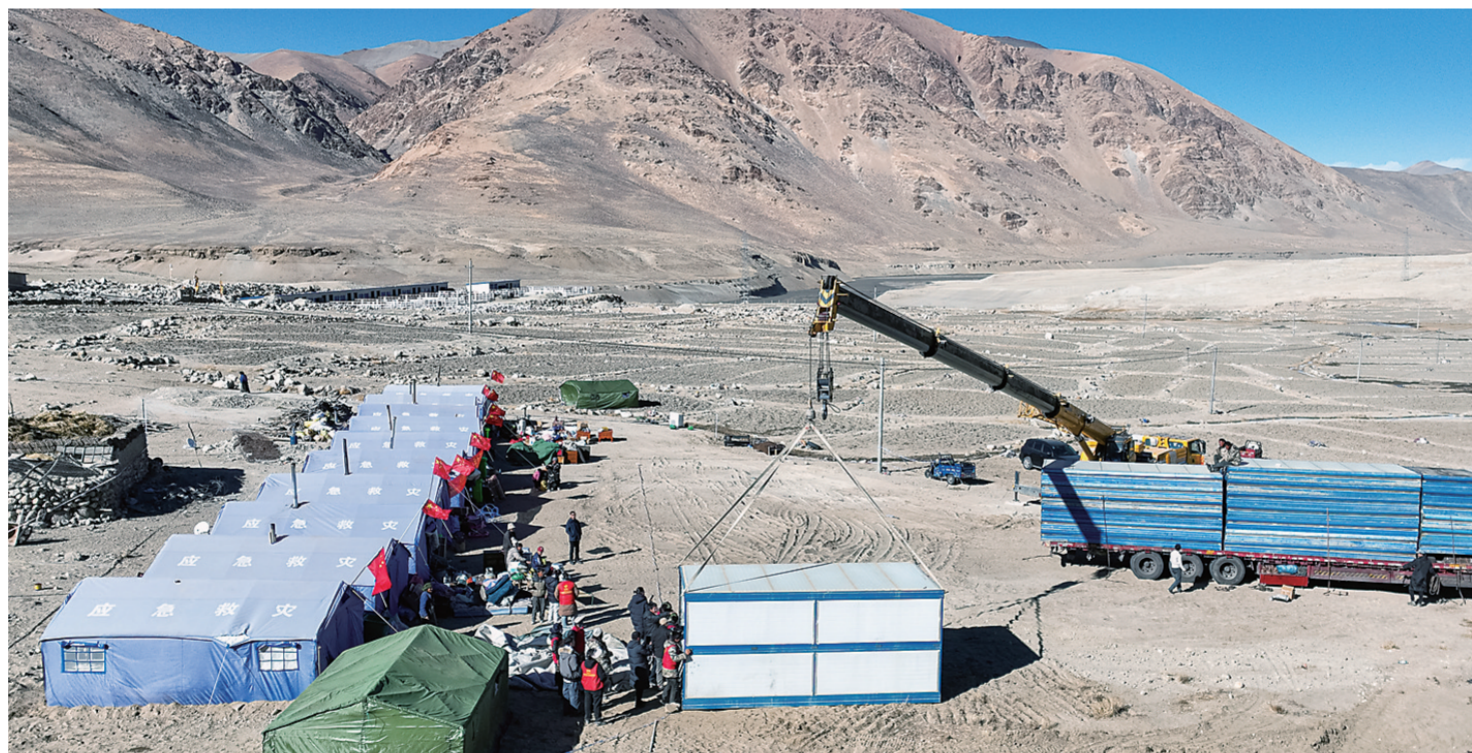
在定结县郭加乡乃村集中安置点，吊车在吊运活动板房(1月11日摄，无人机照片)。1月7日，西藏日喀则市定日县发生6.8级地震，与定日县相邻的定结县郭加乡也受到波及，群众房屋出现不同程度受损。目前，郭加乡共设置八个集中安置点，确保群众温暖过冬。
