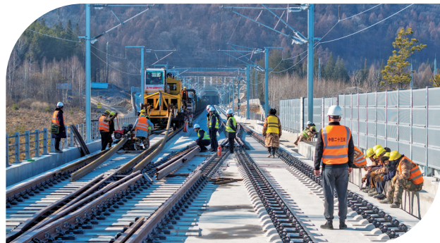
今年，连接沈阳与长白山的沈白高铁将竣工通车，白山也将正式进入“高铁时代”，为发展冰雪经济提供强有力的交通保障。图为承建沈白高铁吉林段TJ—6标的中铁二十三局集团沈白高铁项目部加紧施工，确保工程如期竣工。
