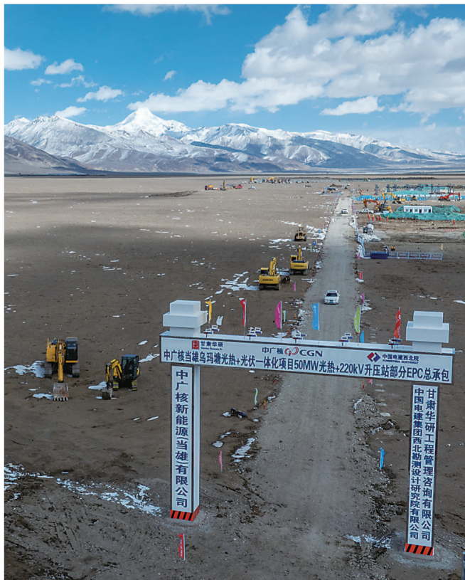
这是中广核西藏当雄玛玛塘50兆瓦光热电站破土动工现场(4月6日摄，无人机照片)。4月6日上午，中广核西藏当雄玛玛塘“光热+光伏”一体化项目中的50兆瓦光热电站在拉萨市当雄县玛玛塘乡正式开工建设。据中广核光热技术型首席专家尹航介绍，该项目海拔4550米，是目前全球海拔最高的槽式光热电站。
