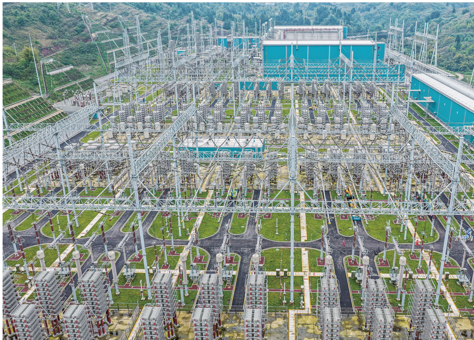
这是4月15日拍摄的“疆电入渝”工程渝北换流站(无人机照片)。4月15日，哈密至重庆±800千伏特高压直流输电工程双极直流系统由运行转检修，标志着“疆电入渝”工程启动首次年度集中检修。“疆电入渝”工程起于新疆哈密巴里坤换流站，工程自投产以来累计输送电量超200亿千瓦时。
