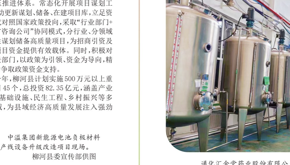
通化汇金堂药业股份有限公司中药制剂专项技改扩能提质项目现场。 吕晶 摄
