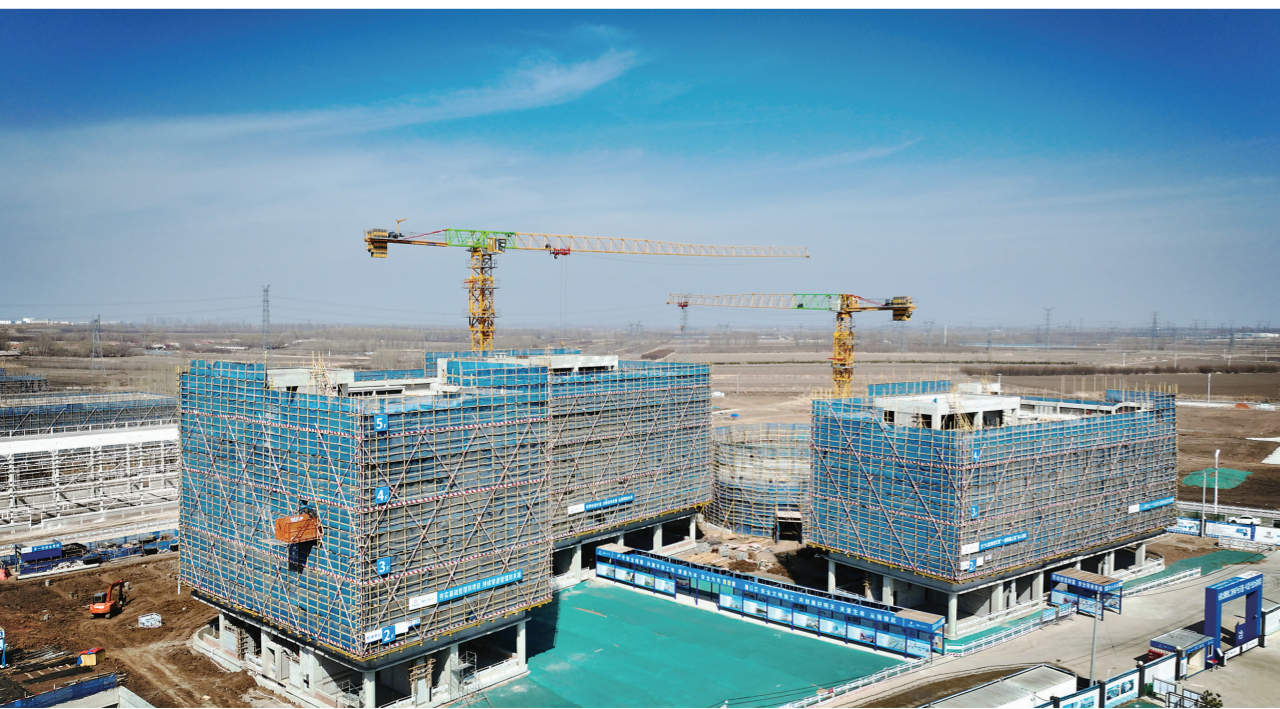
日前，长春新区新材料中试及产业放大基地项目全面复工。项目打造集概念验证、中试孵化、产业放大于一体的共享平台，建成后有力破解科技成果从实验室走向产业化的“最后一公里”难题，成为东北地区精细化工领域创新转化的核心引擎。本报记者 潘硕 摄
