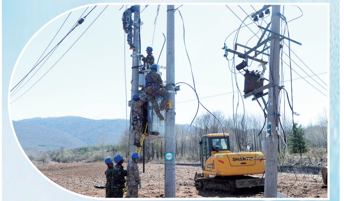
国网白山市城郊供电公司着力改善浑江区农村电网，提升供电可靠性。图为工作人员在红土镇镇更换变压器。
