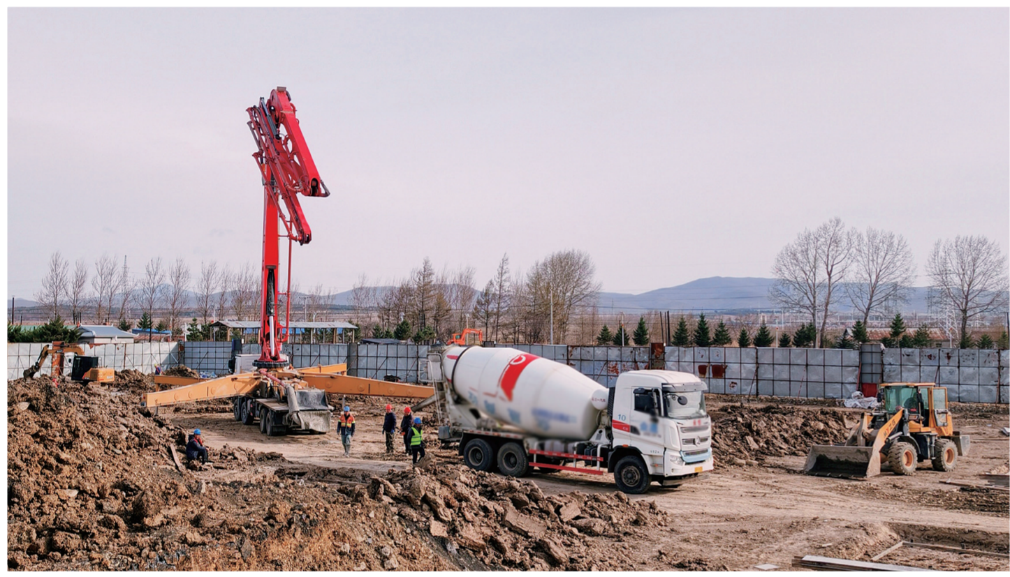
在珲春泛海国际贸易有限公司国际物流仓储园区项目施工现场,泵车正在将高标混凝土浇筑到基座模板里,一派忙碌景象。
